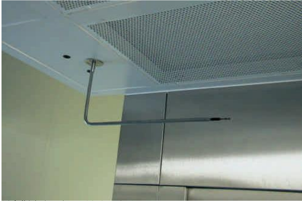
层流监测 在一个 LF-屋顶下 应用 SS 20.502. 变换器在洁净室的屋顶夹层中
